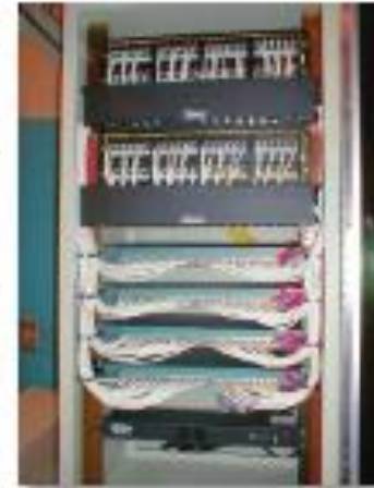
Fig. 2.4. Vistas de un rack para cableado estructurado.
