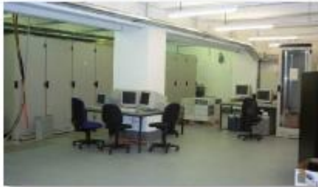
Fig. 2.23. Vista de las canalizaciones en la instalación inicial de un centro de proceso de datos.
