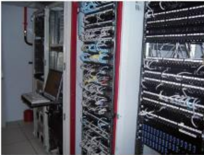
Fig. 3.33. Vista de un cuarto de comunicaciones instalado con cableado estructurado y certificado.
